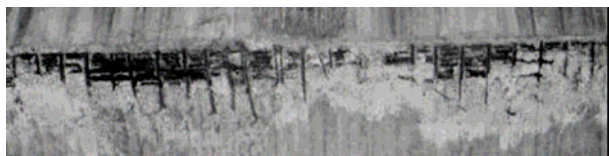
b) oštećenje utvrđeno posle uklanjanja oštećenog betona
