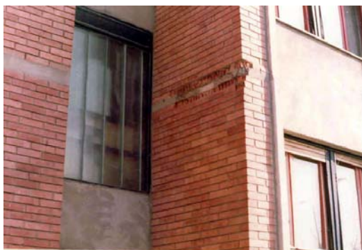
Slika 1 - Raspadanja opeka u fasadnom zidu kao posledica odigravanja fenomena vlažnog širenja u uslovima sprečenog širenja
