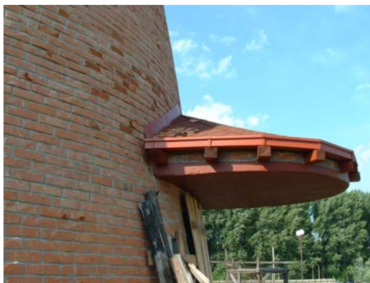
Slika 11 - Prikaz oštećenja opeka usled neadekvatne hidrofobne zaštite
