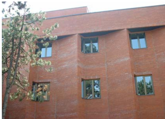
Slika 4 - Pojava rastvornih soli koje umanjuju estetski izgled zida
