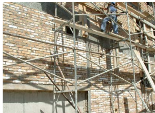
Slika 5 - Pojava rastvornih soli u toku zidanja koja ometa malterisanje
