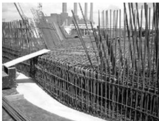
Слика 5 - Густо арматурни склоп, за који је примјењен бетон са додатком "HRWRA"
