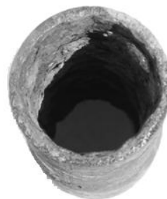
Slika 2 - Opšta korozija cevi bušotina
